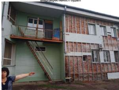
дворовий фасад та простір двору пошкоджені ураганом секції на фасаді без утеплення стін, лустир у дворі, прибудована драбина на 2й поверх
